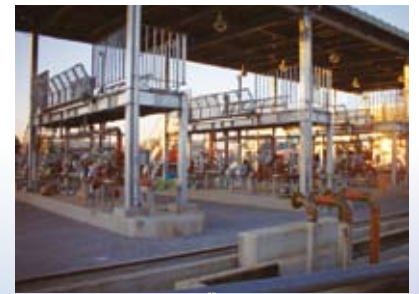
● ローリー受入設備
