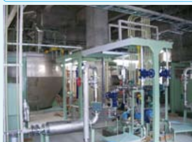
● 水処理プラント
