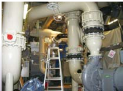
● 熱源供給設備
