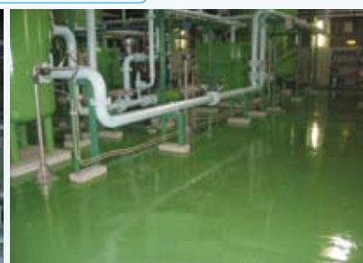
● 水処理センター施設
