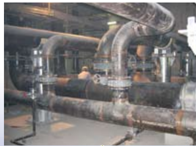
● 地冷配管設備
